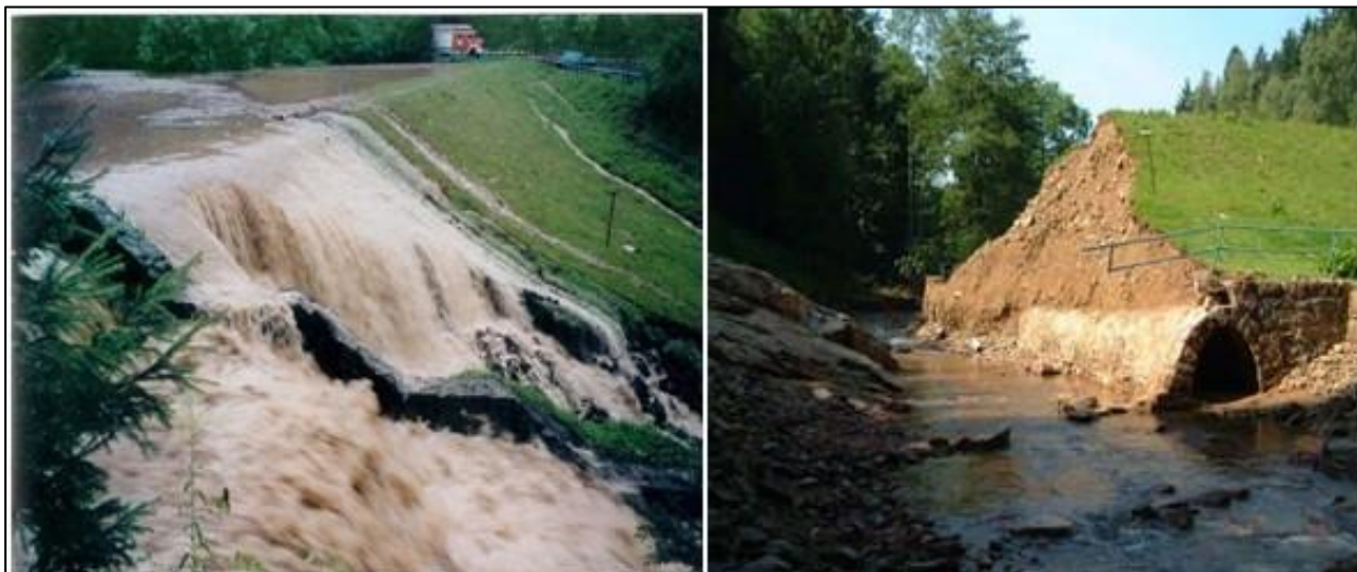
Figura 8. O galgamento de uma barragem de aterro frequentemente resulta na erosão e brecha da barragem. As fotos acima mostram o galgamento e a brecha da barragem de aterro de Glashütte na Alemanha em 23 de agosto de 2002. Fotos da Association of State Dam Safety Officials [Associação de Funcionários Estaduais de Segurança de Barragens] (2025).
